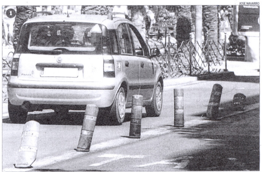
Bolardos deteriorados por impactos de la circulación en la calle Federico Soto.
